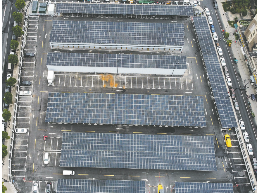
俯瞰前村街停车场,光伏面板整齐排列
